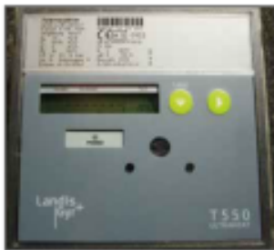
Wärmemengenzähler zur Abrechnung Heizung und/oder Warmwasser.
